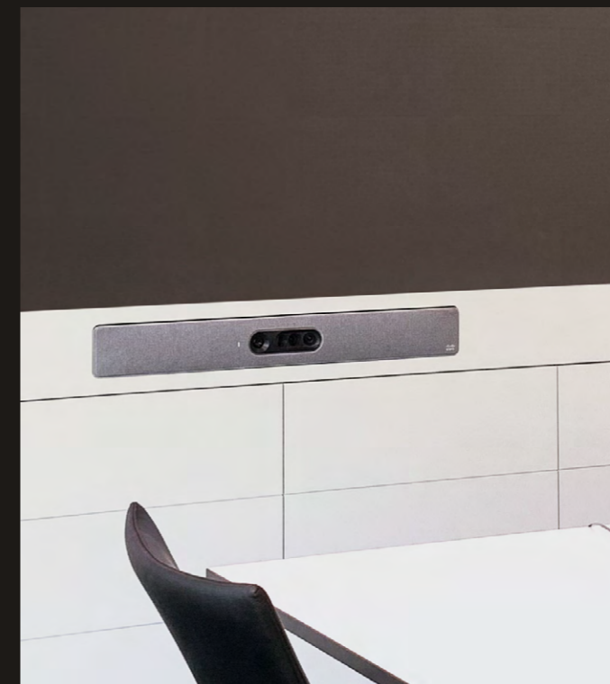
Die Technikblende unterhalb des Screens bietet variable Möglichkeiten, VC-Systeme zu integrieren. Entweder mittels Kamerakorpus für klassische PTZ-Kameras (Abb. oben) oder mit passgenauer Ausfräsung für VC-Soundbars, wie z. B. hier ein Cisco Room Kit Plus. (Abb. unten)
