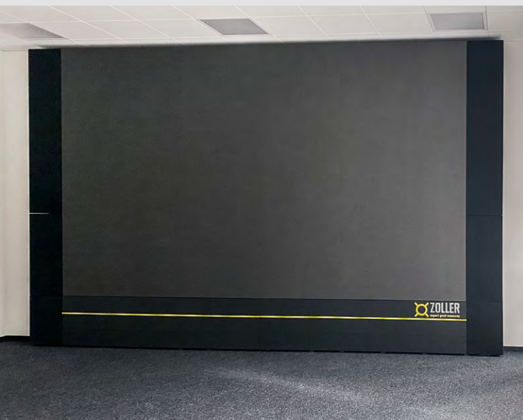
Individuelle 220" LED-Medienwand in einem Auditorium. Mit Lautsprecherkorpus li./re., in Lava-Schwarz.
